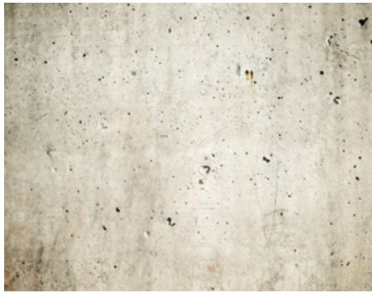
Hormigón con nido de abeja
